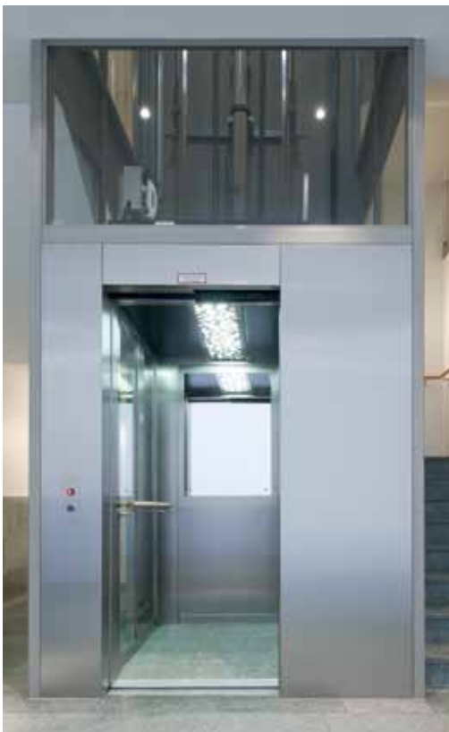
Ansicht Aufzugsanlage mit Schachtgerüst
